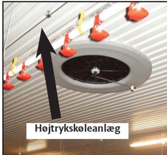
Billede 1: Højtryksskøleanlæg som en del af brandsikkerheden hos Vinni og Povl Larsen.
